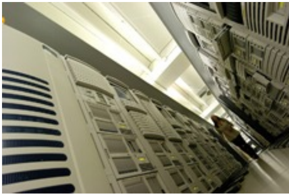
Il data center.
